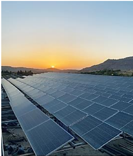
الشكل (13): إحدى محطات الطاقة الشمسية لتوليد الكهرباء في العقبة.
